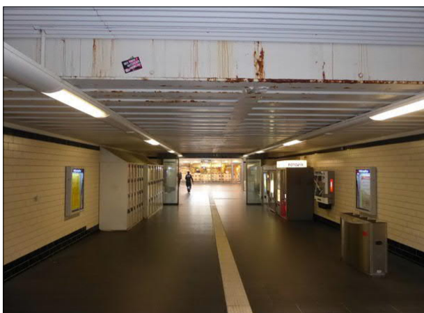
Abbildung 34: An der Decke des Bahnhofstunnels in Bremerhaven Hbf ist zunehmende Rostbildung zu verzeichnen. An einzelnen Stellen tropft Wasser aus den Gleiströgen in den Tunnel.
