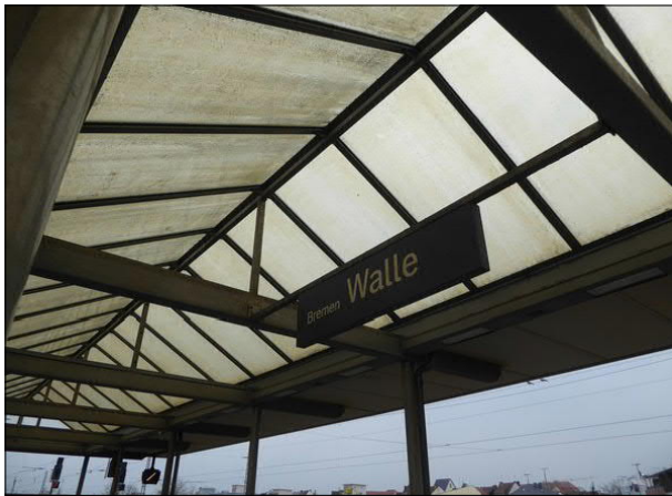
Abbildung 43: Die Scheiben der Bahnsteigdächer in Bremen-Walle und Bremen-Burg sind seit Jahren stark verschmutzt.
