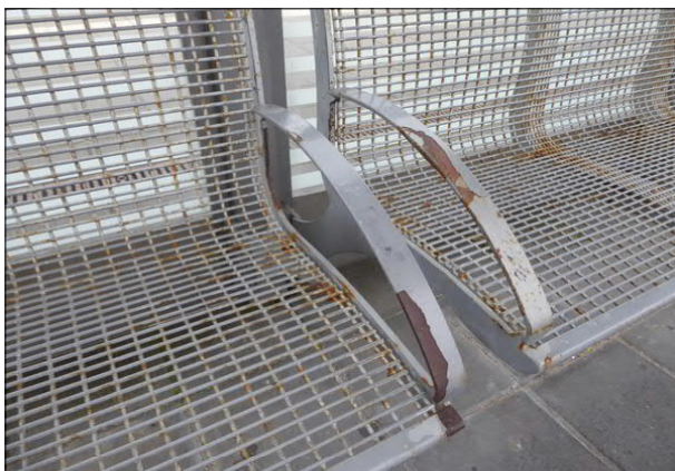
Abbildung 12: Die Sitzbänke im Unterstand von Bremerhaven-Lehe weisen umfangreiche Lackschäden und Korrosion auf.
