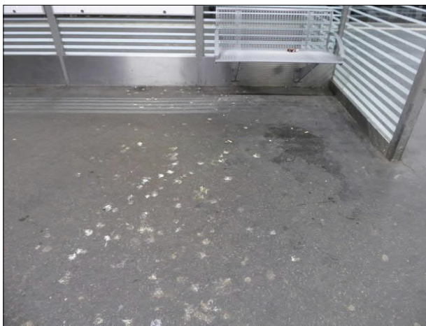
Abbildung 8: Alle Bahnsteige des Bremer Hauptbahnhofs waren bereichsweise verschmutzt. An mehreren Stellen lag Taubenkot.
