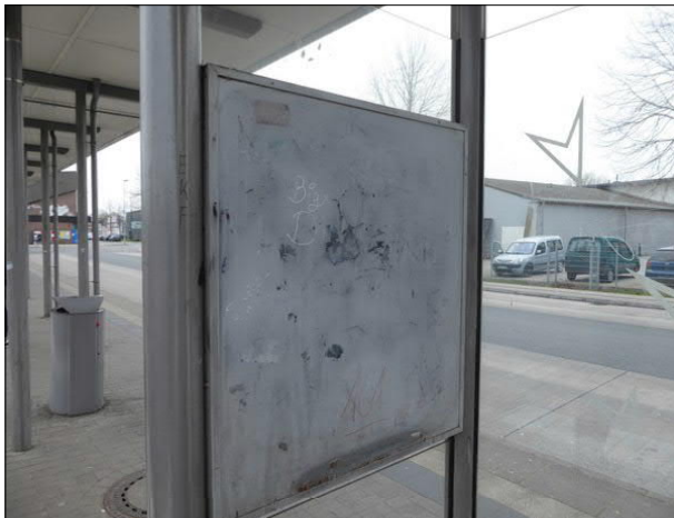
Abbildung 26: Die Rückseiten der Vitrinen in Bremen-Burg sind besonders an Gleis 2 durch Schmutz und Schäden unansehnlich.
