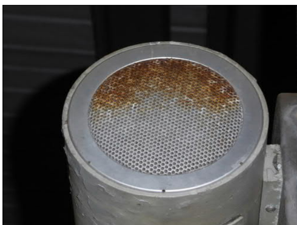
Abbildung 18: An einigen Lautsprechern auf den Bahnsteigen in Bremen Hbf tritt Korrosion auf.
