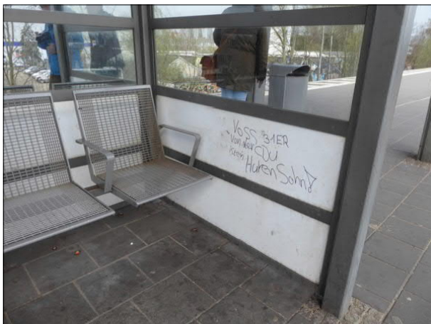
Abbildung 11: Einige Brüstungselemente des Windschutzes in Bremen-Oslebshausen waren verschmutzt oder bekratzelt.
