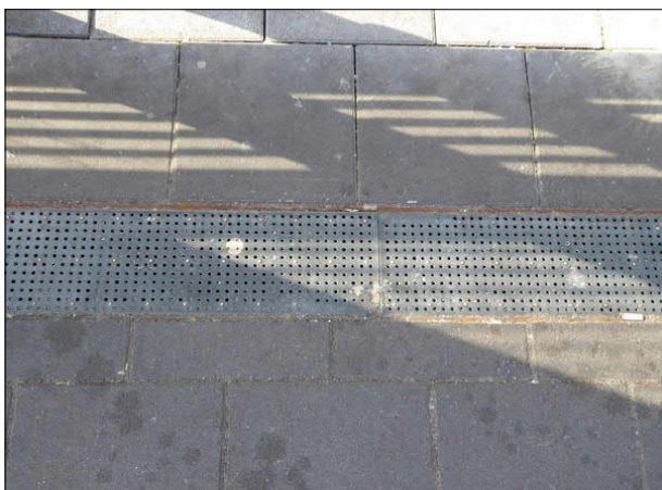
Abbildung 9: An einigen Bahnsteigen im Bereich der FVE ist Rostbildung an den Entwässerungsrinnen zu beobachten. In Bremen Mühlenstraße ist das vor allem in den Unterständen der Fall.
