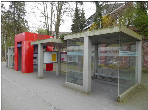
Abbildung 44: Am Wetterschutz in Bremen-Lesum sind vor allem die Dachkanten stark vergrünt. Zudem ist die rote Farbe bereichsweise verblasst.
