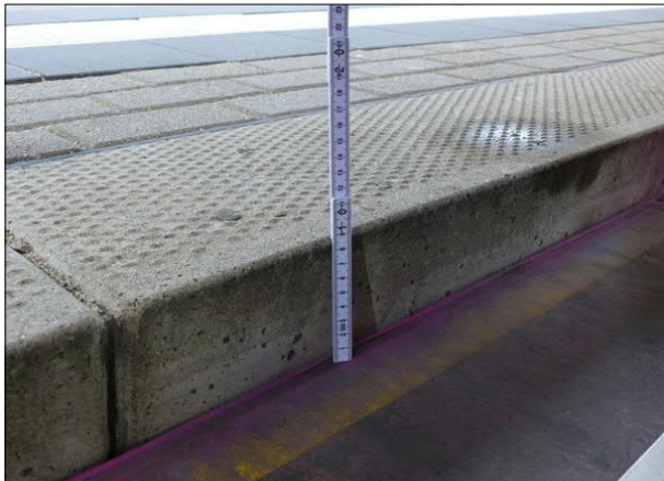
Abbildung 5: In Bremen-Vegesack wurden Stufen von bis zu 9 cm Höhe zwischen dem Bahnsteig und den Trittstufen der S-Bahn gemessen.
