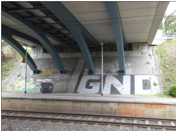
Abbildung 40: In Bremen-Lesum beeinträchtigen weiterhin Schmierereien unter der Brücke und an den Bahnsteigkanten das Erscheinungsbild.
