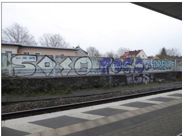
Abbildung 41: Die Lärmschutzwand neben Gleis 6 in Bremen-Walle ist durchgehend mit Graffiti verunstaltet.
