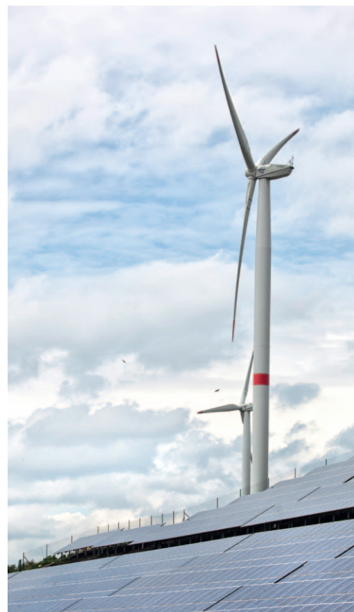
Nutzung erneuerbarer Energien auf der Blocklanddeponie in Bremen
