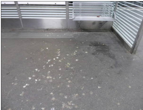
Abbildung 8: Alle Bahnsteige des Bremer Hauptbahnhofs waren bereichsweise verschmutzt. An mehreren Stellen lag Taubenkot.
