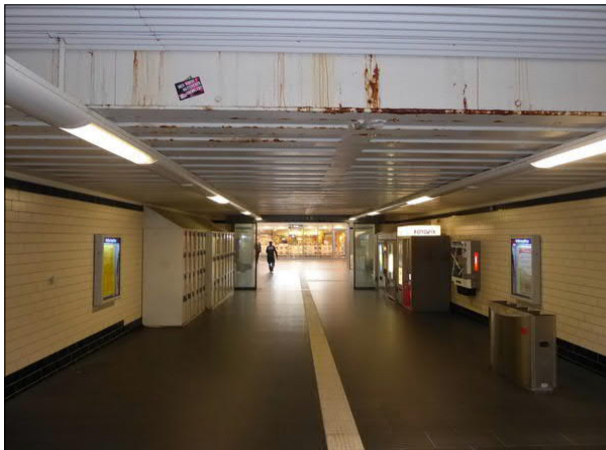
Abbildung 34: An der Decke des Bahnhofstunnels in Bremerhaven Hbf ist zunehmende Rostbildung zu verzeichnen. An einzelnen Stellen tropft Wasser aus den Gleiströgen in den Tunnel.
