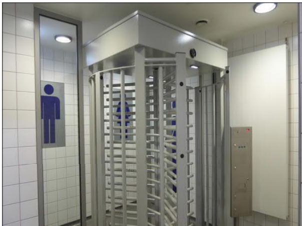
Abbildung 29: Eine Münze steckt im Einlassautomat für das Drehkreuz der WC-Anlage in Bremerhaven Hbf fest. Dadurch war ein Zutritt nicht möglich.
