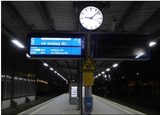
Abbildung 16: Ein Zugzielanzeiger an Gleis 10 in Bremen Hbf war defekt.
