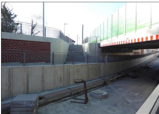
Abbildung 6: Der Weg durch die neue Unterführung zwischen den Bahnsteigen in Bremen-Oberneuland war noch nicht barrierefrei. Auf beiden Seiten mussten Treppen genutzt werden.
