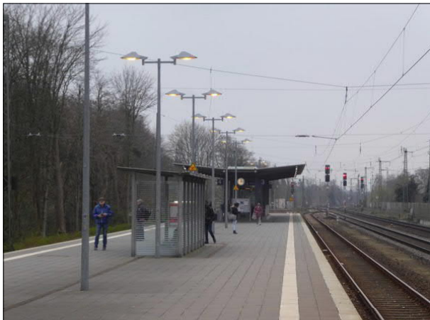
Abbildung 37: In Bremerhaven-Lehe war die Bahnsteigbeleuchtung tagsüber eingeschaltet. Alle Leuchten funktionierten.
