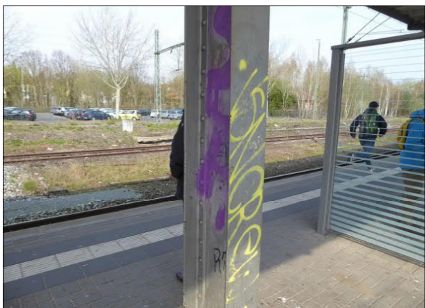
Abbildung 10: Nicht nur Lackschäden an der Dachunterseite, sondern auch größere Schmierereien an den Stützen beeinträchtigen das Erscheinungsbild in Bremen-Vegesack.
