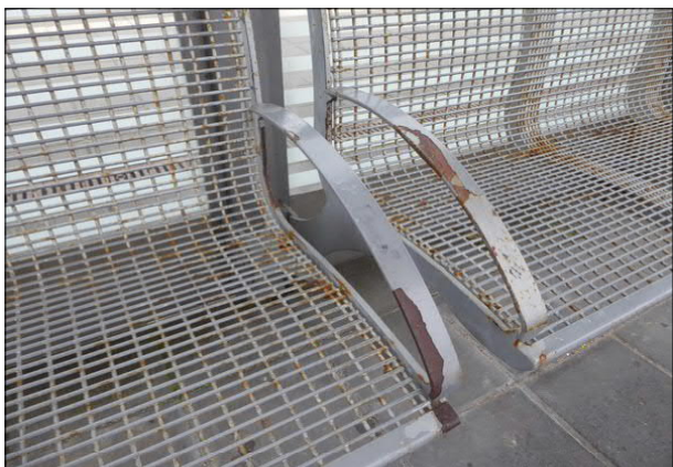
Abbildung 12: Die Sitzbänke im Unterstand von Bremerhaven-Lehe weisen umfangreiche Lackschäden und Korrosion auf.
