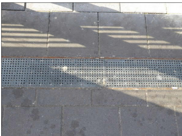
Abbildung 9: An einigen Bahnsteigen im Bereich der FVE ist Rostbildung an den Entwässerungsrinnen zu beobachten. In Bremen Mühlenstraße ist das vor allem in den Unterständen der Fall.
