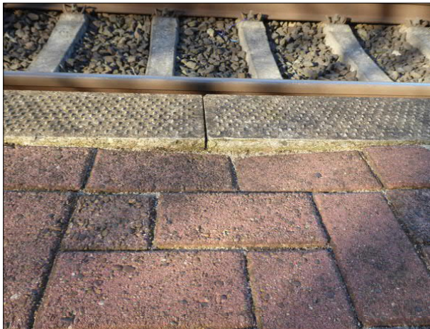
Abbildung 7: An beiden Bahnsteigen in Bremen-Oberneuland gibt es stellenweise Absackungen mit Stufenbildung vor den Bahnsteigkanten.
