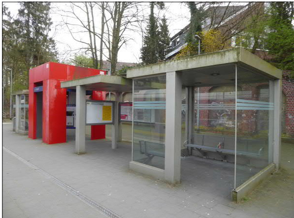
Abbildung 44: Am Wetterschutz in Bremen-Lesum sind vor allem die Dachkanten stark vergrünt. Zudem ist die rote Farbe bereichsweise verblasst.
