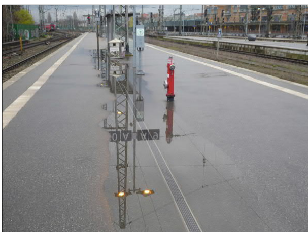
Abbildung 45: Im südlichen Bereich des Bahnsteigs an den Gleisen 9 und 10 in Bremen Hbf war die Entwässerungsrinne offensichtlich verstopft.
