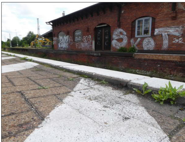
Abbildung 8: Auf dem Bahnsteig in Bremen-Sebaldsbrück war vor den Bahnsteigkanten bereichsweise das Pflaster abgesackt. Dadurch haben sich bis zu 4 cm hohe Stufen gebildet.
