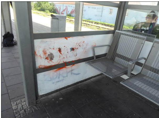
Abbildung 44: Die Brüstungselemente des Windschutzes unter dem Bahnsteigdach in Bremen-Oslebshausen weisen teilweise seit Jahren Schäden auf und waren in diesem Jahr zudem verschmutzt.
