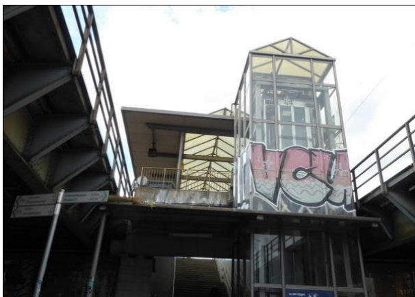
Abbildung 36: Die Graffiti am Aufzugsschacht in Bremen-Walle wurden bei der Erneuerung des Aufzugs von September 2020 bis April 2021 nicht entfernt.
