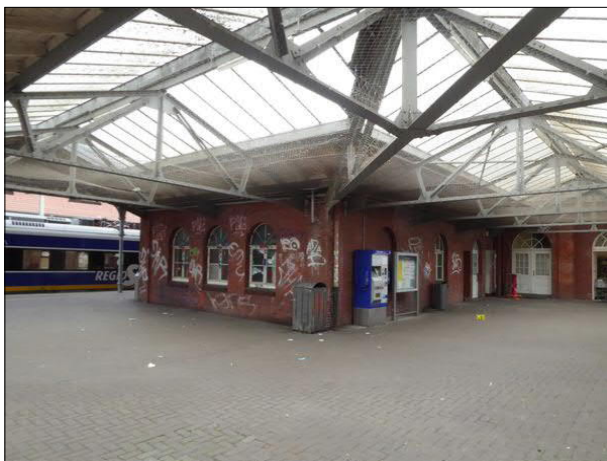
Abbildung 50: Das Erscheinungsbild des Zugangsbereichs zum Bahnsteig in Bremen-Vegesack wird durch die Schmierereien an den Gebäuden und den Ausstattungsgegenständen sowie die verschmutzten Glasdächer stark beeinträchtigt.
