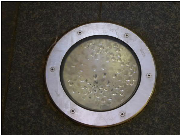
Abbildung 29: In einige Bodenleuchten in den Seitenflügeln des Bremer Hauptbahnhofs ist Wasser eingedrungen. Alle Bodenleuchten sind daher seit einigen Jahren ausgeschaltet.
