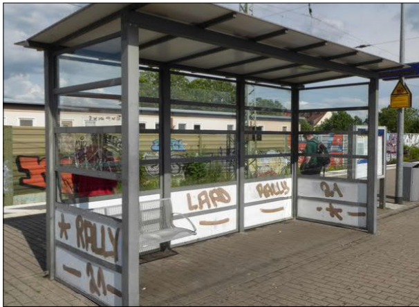
Abbildung 10: Der Unterstand in Bremen-Walle war beschriftet und beschädigt. Eine Scheibe fehlte, eine weitere war stark beschädigt.
