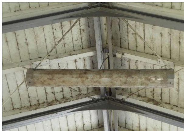
Abbildung 39: Die Leuchte in der Einhausung der Bahnsteigtreppe von Bremen-Sebaldsbrück wurde seit mehreren Jahren nicht gereinigt und ist sehr stark verschmutzt.
