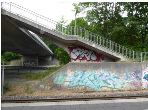
Abbildung 40: Den Ausblick vom Bahnsteig des Bahnhofs Bremen-St. Magnus dominieren einige beschmierte Betonflächen.
