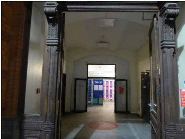
Abbildung 38: Im Eingangsraum des nördlichen Seitenflügels des Bremer Hbf funktionierte die Beleuchtung nicht.
