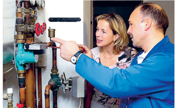
Nach dem Dämmen kommt die Heizung: Die Heizungsanlage ist erst dann wirklich sparsam, wenn sie richtig eingestellt ist.
