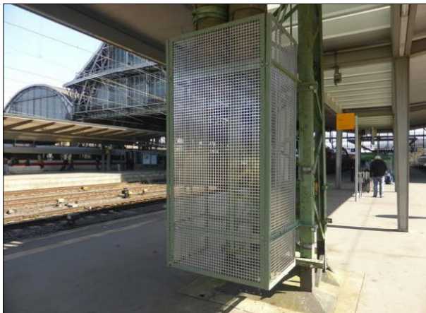
Abbildung 50: An den Gleisen 2/3 in Bremen Hbf wurde die Sicherheitsabdeckung einer Spannvorrichtung erneuert. Seit mehreren Jahren war die alte Abdeckung beschädigt und stellte durch abstehende Drahtenden eine latente Unfallgefahr dar.
