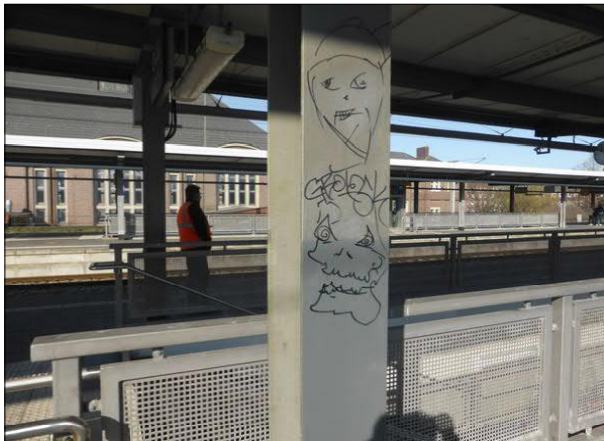
Abbildung 10: In Bremerhaven Hbf waren einzelne Dachstützen bekritzelt.
