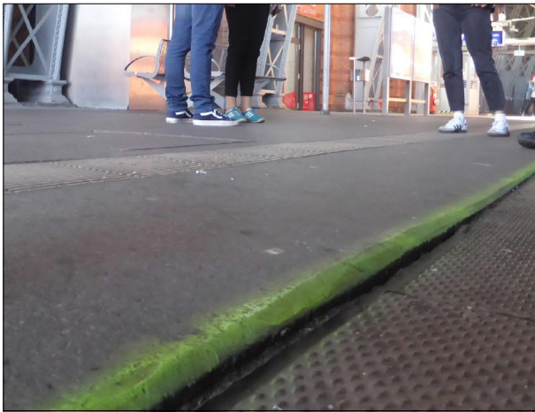
Abbildung 7: In einem Bereich an Gleis 1 ist die Bahnsteigkante in Bremen Hbf ein bis zwei Zentimeter niedriger als der Bahnsteigbelag. Daraus resultierte eine rund fünf Meter breite Stufe mit Stolpergefahr.
