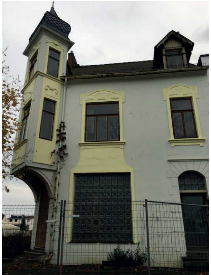
Abb. 50 Leerstand und drohender Verfall ortsbildprägender Gebäude
