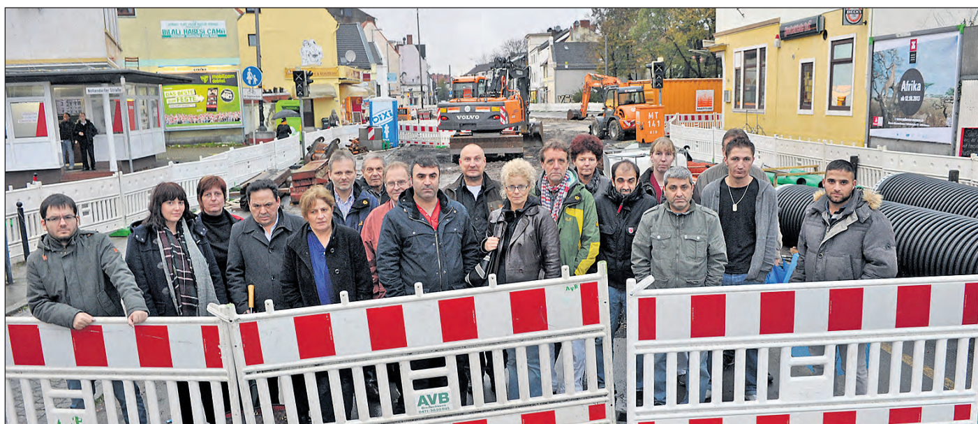
Die Geschäftsleute der hinteren Kornstraße wollen nicht länger mit der Baustelle vor ihren Türen leben.
