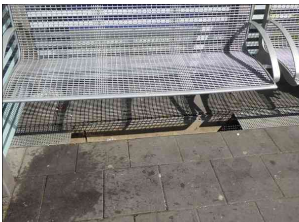
Abbildung 9: Im Unterstand in Bremen-Aumund fehlte ein Element der Abdeckung für die Entwässerungsrinne.
