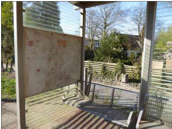
Abbildung 11: Der Wartekomfort in Bremen-Oberneuland wird durch eine fehlende Scheibe sowie die verschmutzten und beschädigten Vitrinenrückwände beeinträchtigt.
