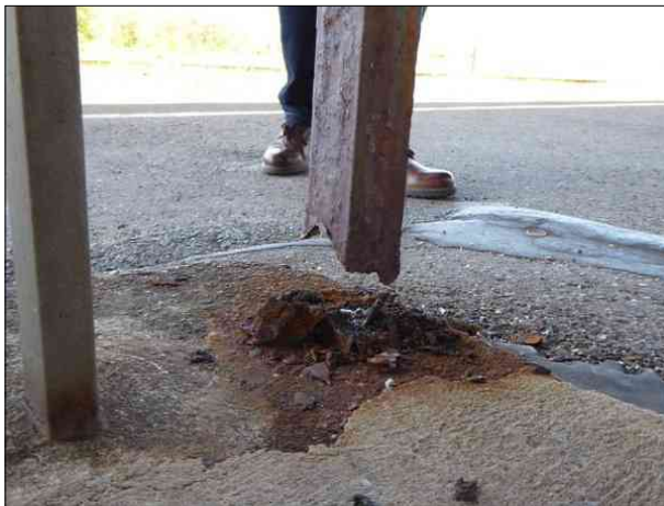
Abbildung 50: Diese Geländerstütze am Treppenabgang in Bremen-Neustadt ist durchgerostet.
