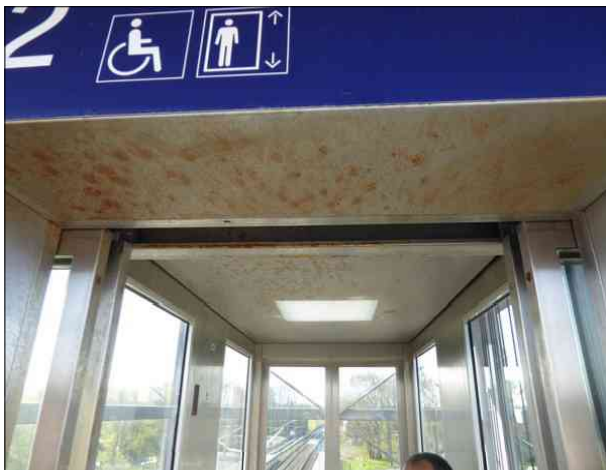
Abbildung 35: An den erst vor zwei Jahren in Betrieb genommenen Aufzügen in Bremen-Mahndorf hat sich auf einigen Flächen Rost gebildet.
