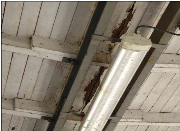
Abbildung 10: Das Bahnsteigdach in Bremen-Vegesack ist stellenweise beschädigt.
