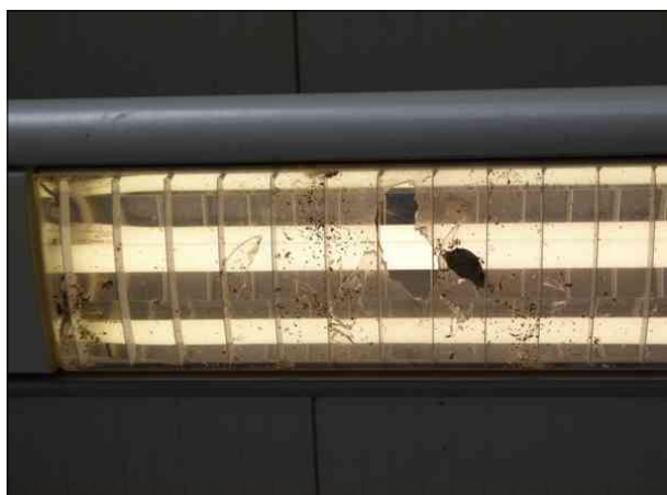
Abbildung 37: In Bremerhaven Hbf war die Bahnsteigbeleuchtung tagsüber eingeschaltet. Diese Abdeckung der Lichtleiste des Bahnsteigdachs an Gleis 5 war beschädigt.
