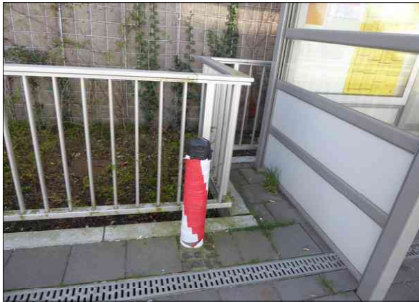
Abbildung 16: In Bremen-Mahndorf war an Gleis 1 der Mast eines Dynamischen Schriftanzeigers abgebrochen.
