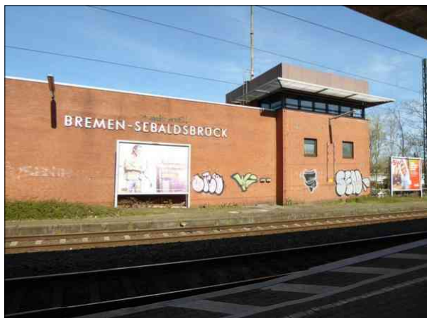
Abbildung 40: Die Graffiti am Stellwerk in Bremen-Sebaldsbrück beeinträchtigen das Erscheinungsbild.
