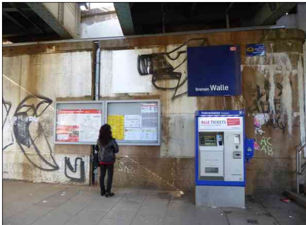
Abbildung 25: Die bereichsweise stark zerkratzen Vitrinen am Zugang in Bremen-Walle wurden erneuert. Die Schmierereien an den Wänden sind jedoch geblieben.
