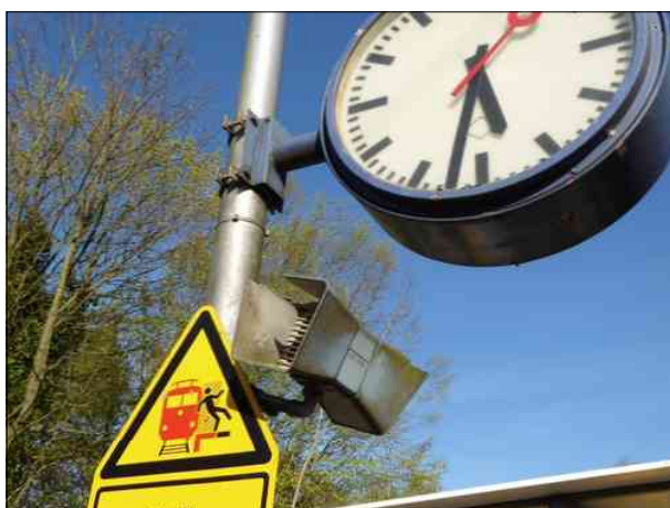
Abbildung 18: Dieser Lautsprecher an Gleis 2 in Bremen-Oberneuland war beschädigt.
