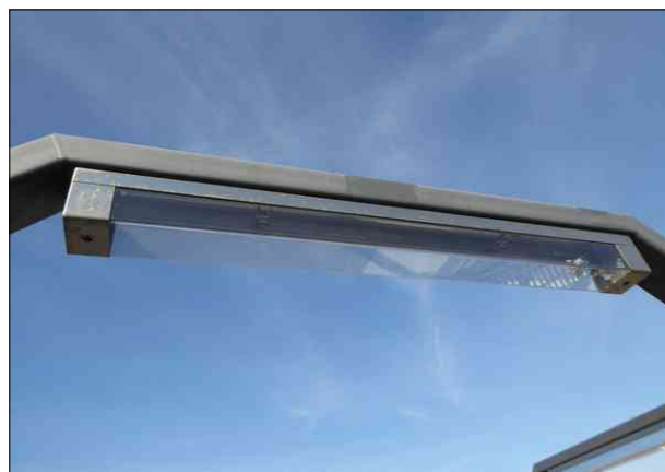
Abbildung 39: Diese Lampe auf der Brücke in Bremen-Mahndorf war nicht mit einem Leuchtmittel bestückt.
