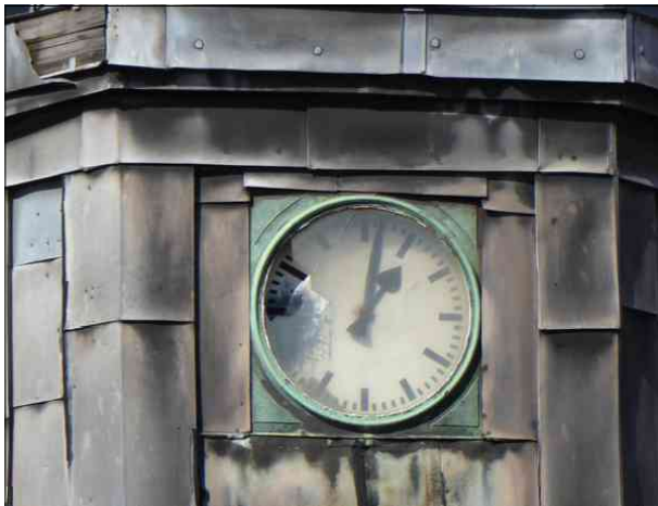
Abbildung 20: Die Uhr auf der Gleisseite des ehemaligen Empfangsgebäudes in Bremerhaven-Lehe funktionierte nicht. Zudem war das Glas beschädigt.
