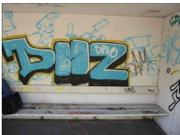
Abbildung 45: Die Betonunterstände in Bremen-Hemelingen wiesen zum großen Teil die selben Schmierereien auf wie vor einem Jahr.
