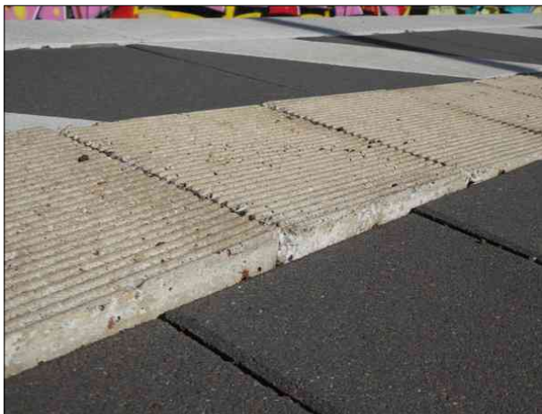
Abbildung 7: An Gleis 6 in Bremen-Walle war der Blindenleitstreifen an einer Stelle etwas angehoben.
