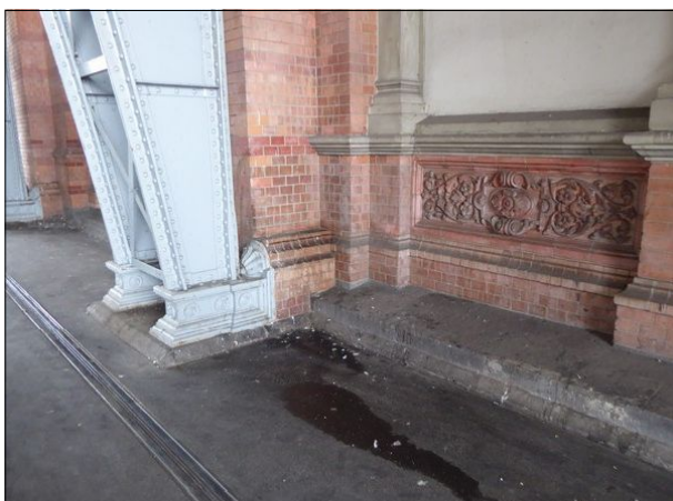
Abbildung 9: Sehr un schön ist, dass der Bahnsteig an Gleis 1 in Bremen Hbf an mehreren Stellen als Toilette missbraucht wird.
