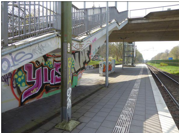
Abbildung 44: Treppensockel, Schaltkästen und Oberleitungsmasten auf dem Bahnsteig in Bremen-St. Magnus waren wieder umfangreich beschmiert.
