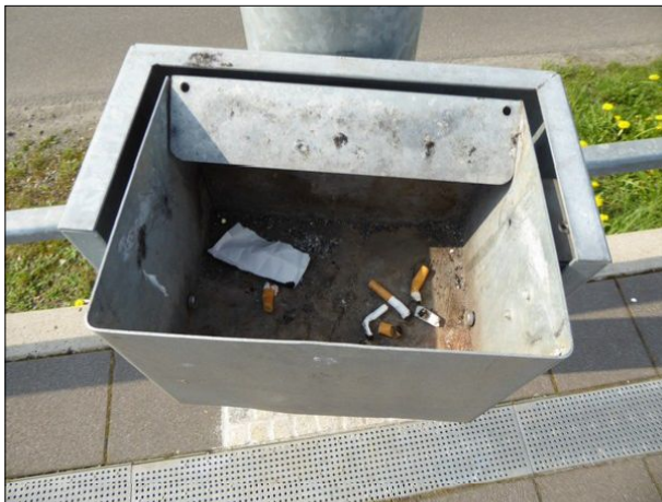
Abbildung 14: Bei einigen Aschenbechern an der Strecke Vegesack - Farge fehlten die eingesetzten Roste. Betroffen ist auch dieser Behälter in Bremen Turnerstraße.
