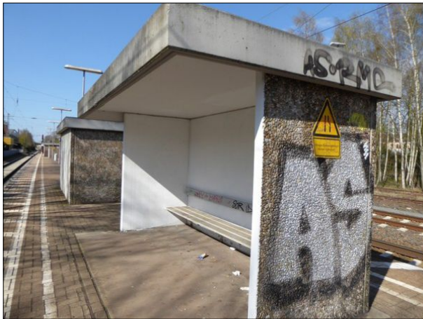
Abbildung 11: Die Innenwände der Unterstände auf dem Bahnsteig in Bremen-Hemelingen wurden neu gestrichen. Auf den Bänken und auf den Außenwänden wurden die Schmierereien jedoch nicht entfernt.
