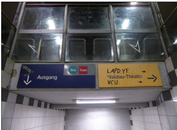
Abbildung 47: Die Wegleitungsschilder am Treppenaufgang des Bahnhofs Bremen-Walle waren bekratzelt.
