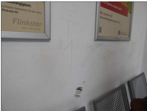
Abbildung 29: Im Bremer Hauptbahnhof waren die Wände des Warteraums etwas verschmutzt und bekratzelt.
