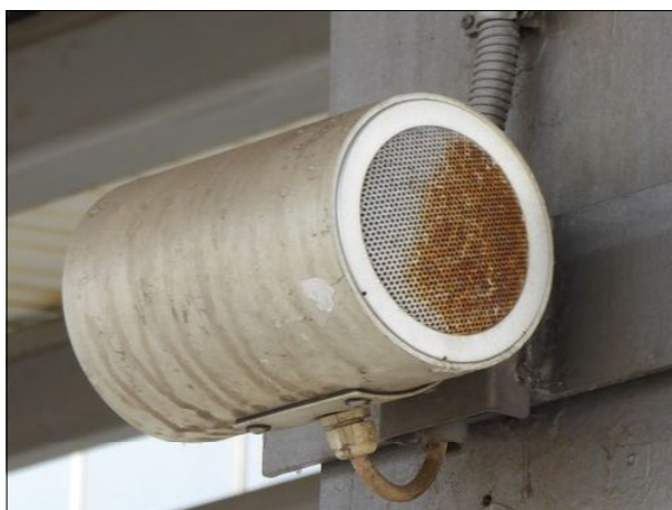
Abbildung 18: In Bremen Hbf waren einige der neueren Lautsprecher angerostet. Meist war nur eine Seite betroffen.
