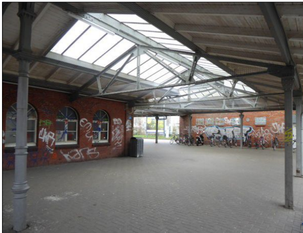
Abbildung 35: In Bremen-Vegesack wurde das Dach im Zugang mit einem Netz abgehängt, um den Aufenthalt von Tauben zu verhindern. Die umfangreichen Schmierereien und Taubenkot prägen jedoch nach wie vor diesen Bereich.
