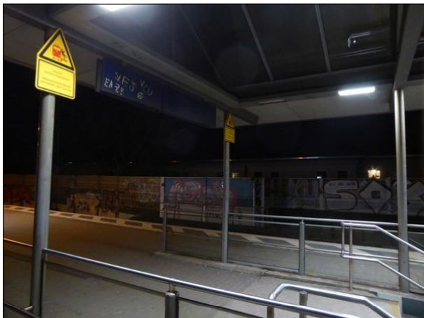
Abbildung 38: An der Überdachung auf dem Bahnsteig in Bremen-Walle waren drei Leuchten defekt.
