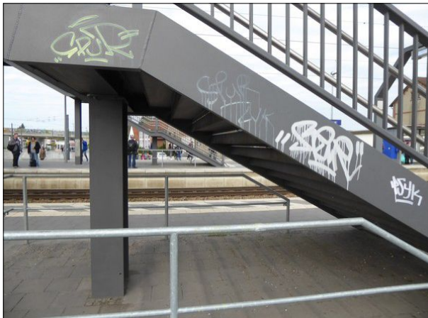
Abbildung 34: Durch zahlreiche Schmierereien an der Brücke in Bremen-Mahndorf wird das Erscheinungsbild beeinträchtigt.
