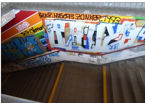
Abbildung 51: Die Schmierereien an den Wänden im Tunnel und am Treppenaufgang zum Bahnsteig in Bremen-Neustadt waren deutlich umfangreicher als im Frühjahr 2015.
