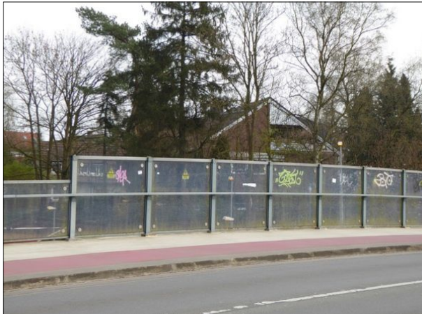
Abbildung 40: Die Scheiben auf der Brücke in Bremen-Lesum sind weiterhin verschmutzt und beschmiert.
