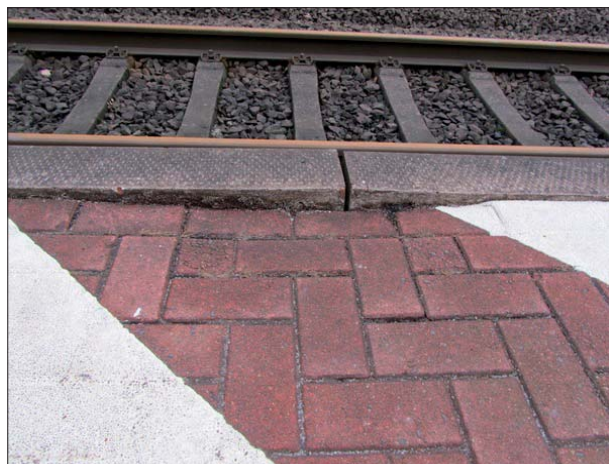
Abbildung 4: Der Bahnsteig an Gleis 3 in Bremen-Oberneuland wies größere Absackungen mit Stufenbildung an den Bahnsteigkanten auf.
