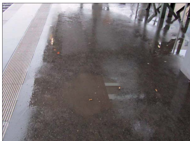
Abbildung 6: Auf den neuen Bahnsteigen des Hauptbahnhofs in Bremen bildeten sich Pfützen.
