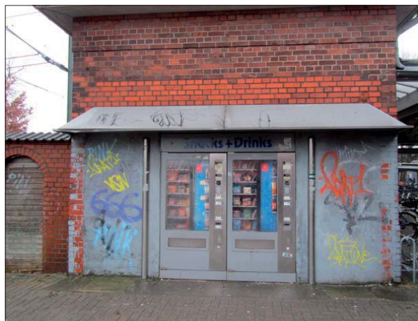
Abbildung 32: Der Zugangsbereich in Bremen-Vegesack ist durch umfangreiche Schmierereien nicht einladend.
