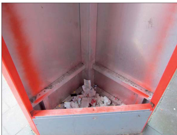
Abbildung 12: Die nicht verkleidete Säule des sogenannten Pluspunkts in Bremen-Lesum wird als Müllbehälter genutzt.
