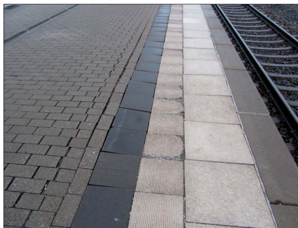
Abbildung 5: Die Schäden und Unebenheiten am Mittelbahnsteig von Bremen-Burg sind deutlich zu erkennen.
