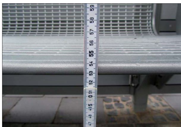
Abbildung 9: Die Sitzbänke in den Fahrgastunterständen des Bahnhofs Bremen-St. Magnus sind deutlich höher installiert als die geforderten 45 cm über dem Bahnsteig.
