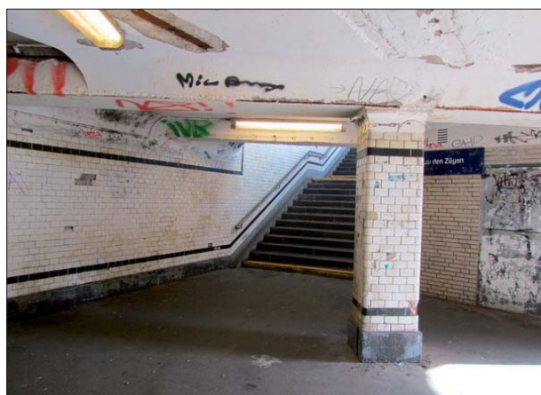
Abbildung 2: Umfangreiche Schäden und Verschmutzungen weist der Zugangstunnel in Bremen-Sebaldsbrück auf.
