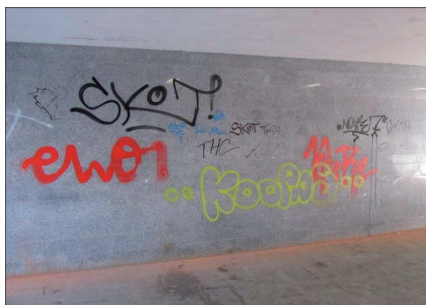
Abbildung 33: Auch in der städtischen Unterführung als Zugang zum Bahnsteig in Bremen-Hemelingen gab es umfangreiche Schmierereien.
