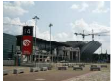
Messe und Congresszentrum Bremen sowie der AWD-Dome (Stadthalle) während der Umbau- und Erweiterungsphase im Jahr 2004
