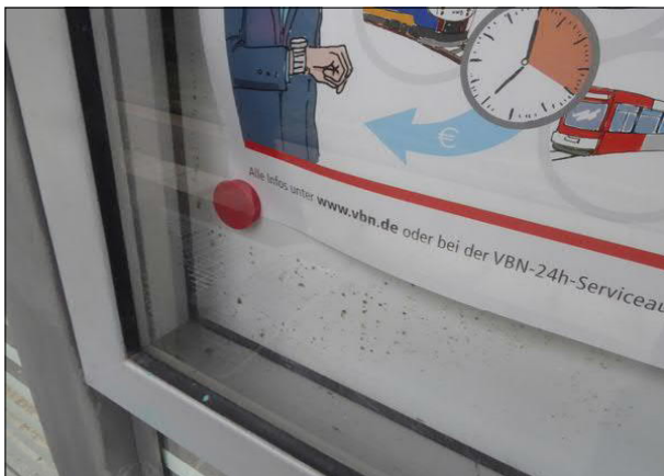
Abbildung 27: Auf der Rückwand in der westlichen Vitrine des Haltepunkts Bremen Mühlenstraße hat sich bereichsweise Schimmel gebildet.
