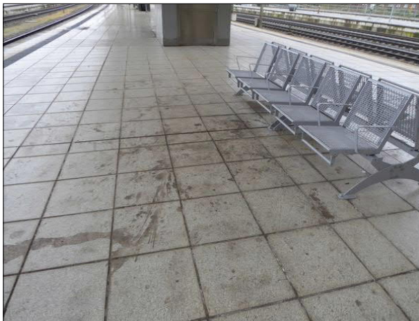
Abbildung 8: Die Bahnsteige in Bremen Hbf sind nicht nur durch Taubenkot verschmutzt. Dieses Foto zeigt den Bahnsteig der Gleise 5/6.
