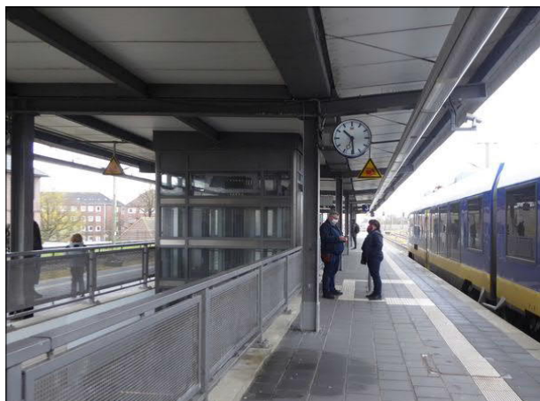
Abbildung 44: Das Bahnsteigdach an den Gleisen 2/3 in Bremerhaven Hbf war an einzelnen Stellen undicht.
