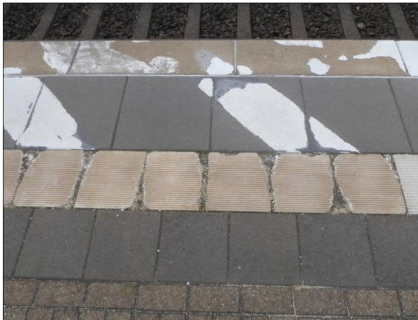
Abbildung 7: In Bremen-Walle sind einige Platten der Blindenleitstreifen auf dem Bahnsteig beschädigt. Außerdem platzt die Gefahrenbereichsmarkierung bereichsweise ab.
