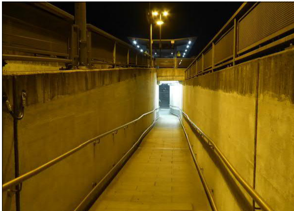
Abbildung 49: An der Rampe zum Bahnsteig in Bremen-Oslebshausen wurden sämtliche Fliesen von den Wänden entfernt.
