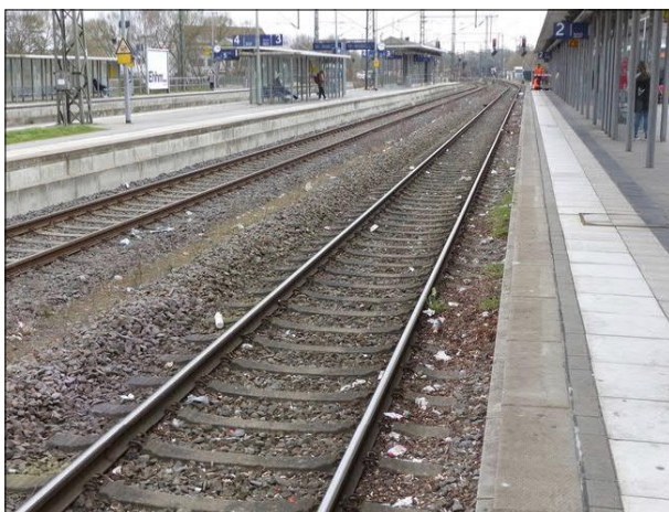
Abbildung 15: Das Gleis 2 in Bremen-Burg war stark verunreinigt.
