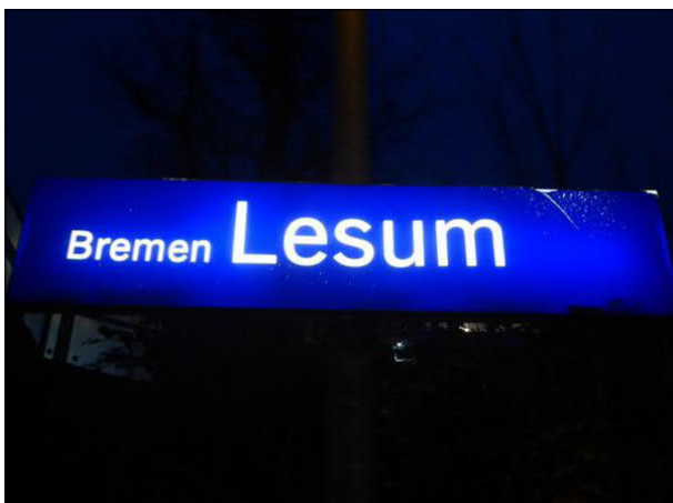
Abbildung 21: An jedem der beiden Bahnsteige in Bremen-Lesum funktionierte die Beleuchtung nur an jeweils einem Bahnhofnamensschild.
