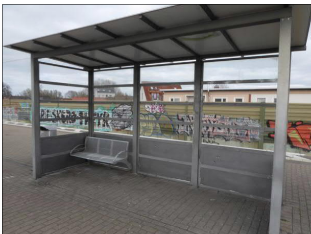
Abbildung 11: Im Unterstand in Bremen-Walle fehlten 15 Scheiben. Zudem waren eine weitere Scheibe und die Brüstung beschädigt.
