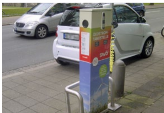
Ladepunkt im öffentlichen Straßenraum
