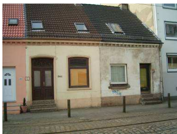
Wohnhäuser am Buntentorsteinweg: schlechter Zustand der Fassade
