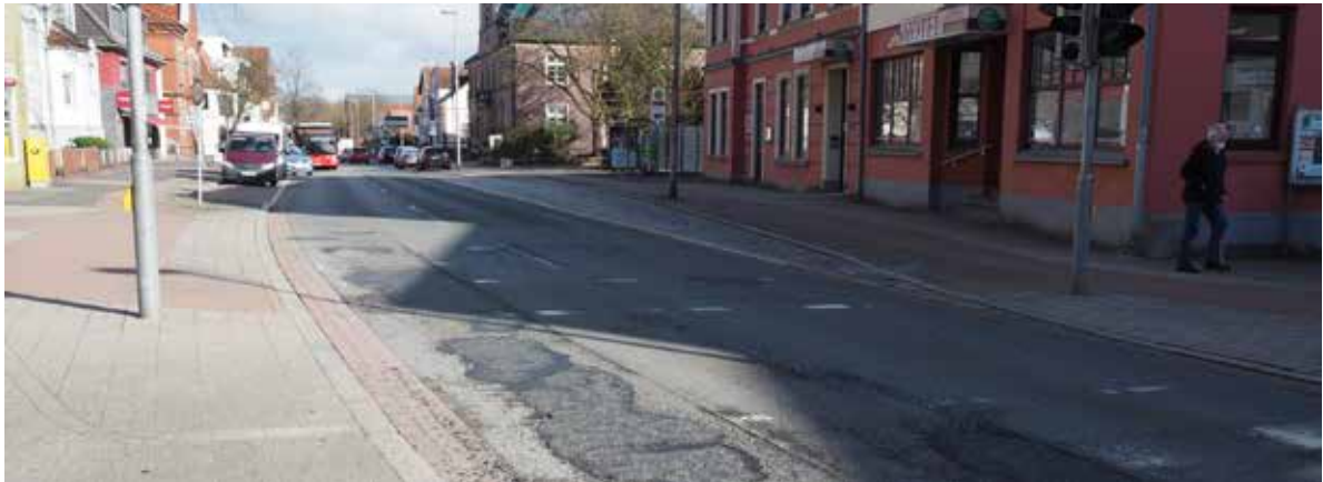
Abb. 28 Querung über die Landrat-Chr.-Str. zum Marktplatz mit technischen Oberflächenmängeln
