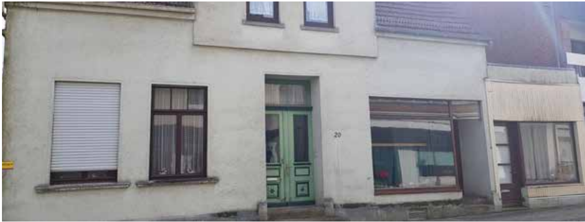
Abb. 59 Hoher Sanierungsstau bei stadtbildprägenden Gebäuden
