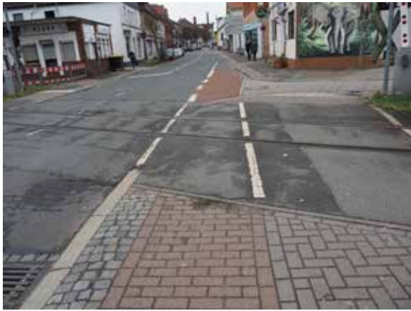
Abb. 32 Mangelhafte Radwegführung Mühlenstr.
