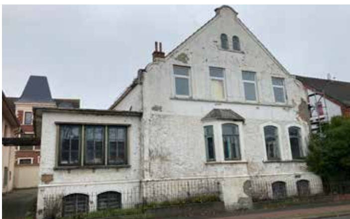
Abb. 16 Historische Gebäudesubstanz mit hohem Handlungsbedarf
