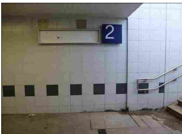
Abbildung 21: Im Tunnel von Bremen-Burg fehlte die Haube eines Wegeleitungsschildes.
