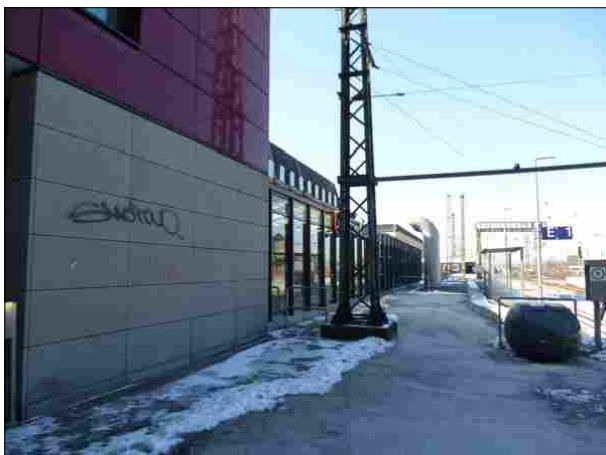
Abbildung 38: Die Fassade der am Bahnsteig des Gleis 1 in Bremen Hbf gelegenen Fahrradstation war beschmiert.
