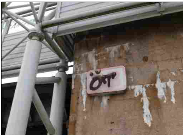
Abbildung 20: Das DB-Logo in Bremen-Walle als Kennzeichnung des Bahnsteigzugangs unter der Brücke ist verblieben und beschmiert.
