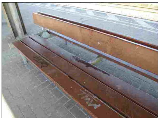
Abbildung 42: Diese Bank in Bremen-Sebaldsbrück war bekritzelt. Durch das Bahnsteigdach tropfendes Wasser führte außerdem zu Eibildung auf den Lehnen und den Sitzflächen.
