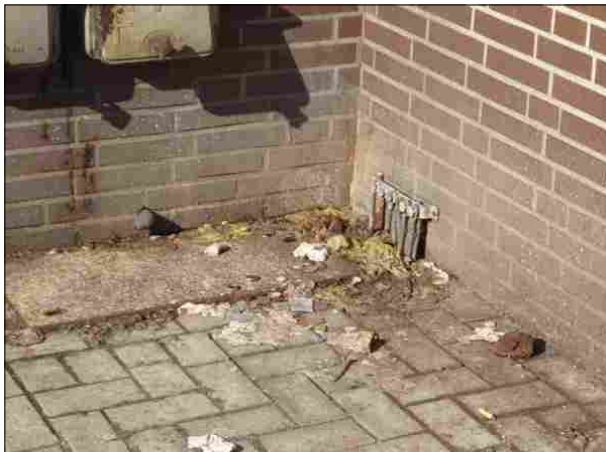
Abbildung 37: Diese Ecke am Bahnsteigzugang neben dem Stellwerk in Bremen-Burg wird offensichtlich des öfteren als Toilette benutzt.
