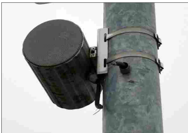
Abbildung 15: In Bremen-Aumund war ein Lautsprecherkabel durchgetrennt.
