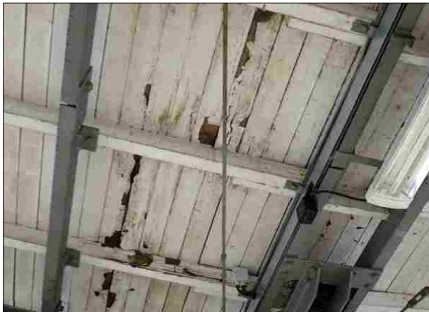
Abbildung 7: Am Bahnsteigdach in Bremen-Vegesack besteht Sanierungsbedarf.
