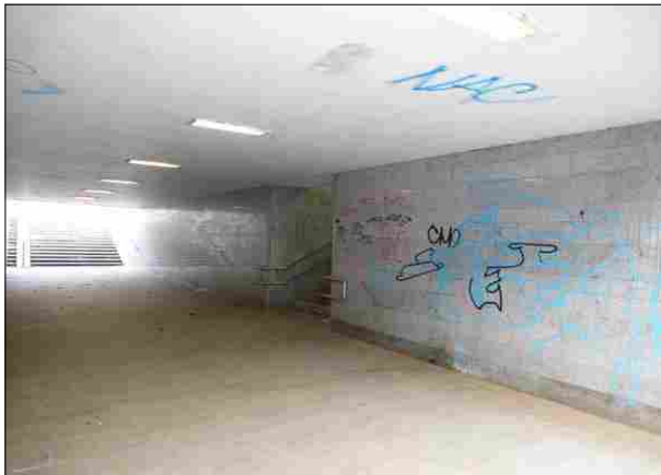
Abbildung 46: Die Wände im Zugang zum Bahnsteig in Bremen-Hemelingen waren erneut stark verunreinigt.
