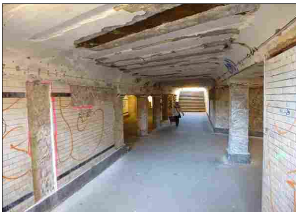
Abbildung 33: Trotz begonnener Sanierungsmaßnahmen dominieren Schäden und Schmierereien die Unterführung in Bremen-Sebaldsbrück.
