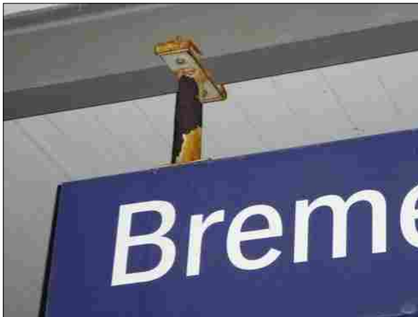
Abbildung 43: Die Halterungen der Bahnhofnamensschilder in Bremerhaven Hbf sind teilweise angerostet.
