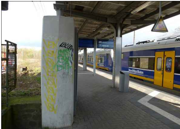
Abbildung 46: Die Betonummantelung dieser Dachstütze in Bremen-Vegesack würde auch ohne Schmierereien das Erscheinungsbild beeinträchtigen.
