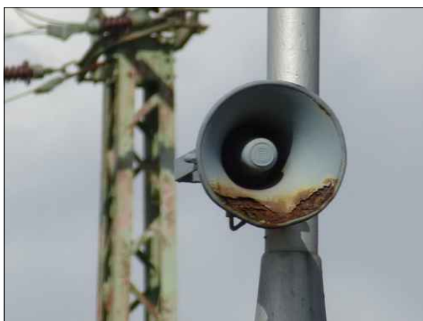
Abbildung 18: Die Lautsprecher in Bremerhaven-Wulsdorf sind teilweise angerostet.
