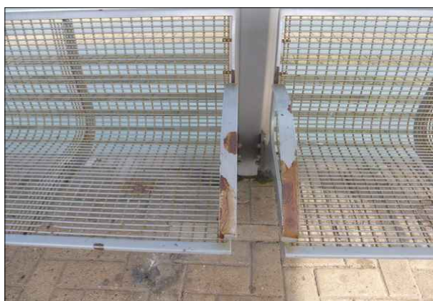
Abbildung 12: Die Bänke im Unterstand von Bremerhaven-Wulsdorf sind stark angerostet und stellenweise angekokelt.
