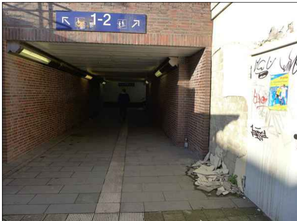
Abbildung 34: Neben einem verschmutzten Schild und Schmierereien fielen auch größere Putzschäden am Zugang zum Bahnhof Bremen-Oslebshausen negativ auf.
