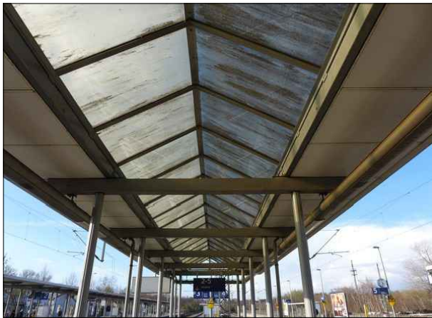
Abbildung 43: Die Dachscheiben in Bremen-Burg sind stark verschmutzt. Die Dächer sind zudem stellenweise undicht.
