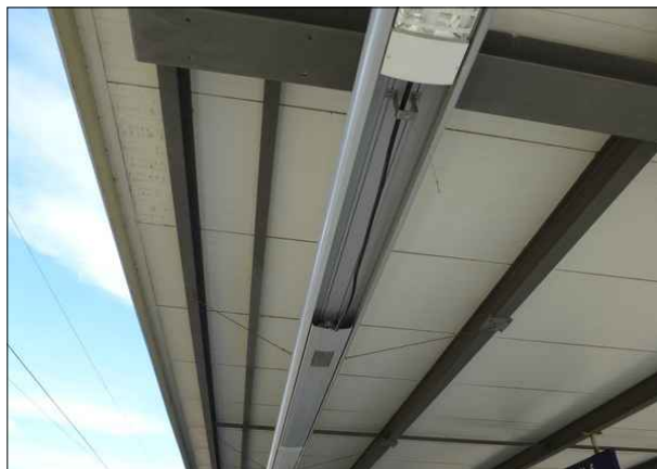
Abbildung 39: Im Hauptbahnhof von Bremerhaven fehlte ein Abdeckblech für den Kabelkanal in der Licht- und Lautsprecherleiste an Gleis 2.
