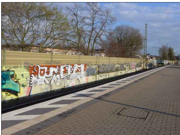
Abbildung 41: In Bremen-Walle beeinträchtigt die beschmierte Lärmschutzwand das Erscheinungsbild.
