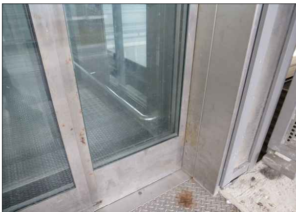
Abbildung 36: An den erst wenige Jahre alten Aufzügen in Bremerhaven Hbf war schon Rostbildung erkennbar.
