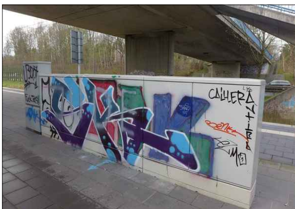
Abbildung 48: Auf dem Bahnsteig in Bremen-St. Magnus beeinträchtigen Schmierereien an den Schaltkästen und Treppenanlagen das Erscheinungsbild.
