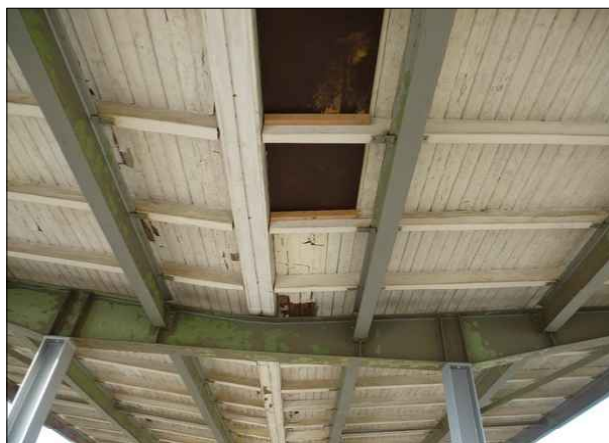
Abbildung 10: Das Bahnsteigdach in Bremen-Neustadt wurde stellenweise geflickt. Eine vollständige Sanierung mit Neuanstrich der Unterseite lässt weiter auf sich warten.
