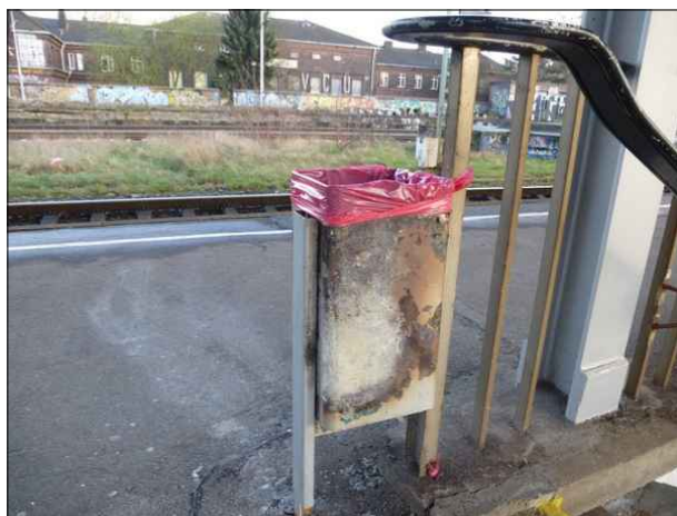
Abbildung 15: Ein Abfallbehälter des Bahnhofs Bremen-Neustadt wies erhebliche Brandschäden auf.
