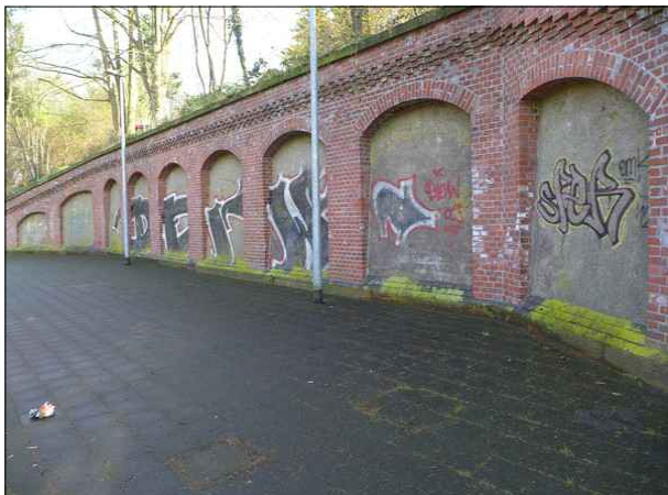
Abbildung 44: An Gleis 1 in Bremen-Lesum ist der Bahnsteigbereich hinter dem Wartebereich bei Feuchtigkeit rutschig. Außerdem beeinträchtigen die Graffiti das Erscheinungsbild.
